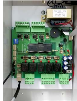
บอร์ดควบคุมภายใน
