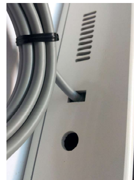
สาย Sensor และรูหลอดสายสำหรับ Relay
